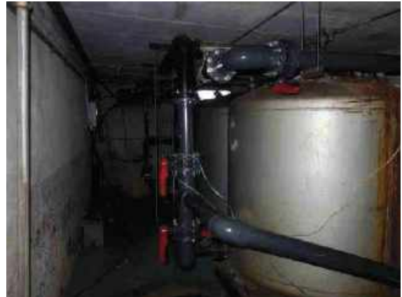
Sous-sol, équipements de la piscine
