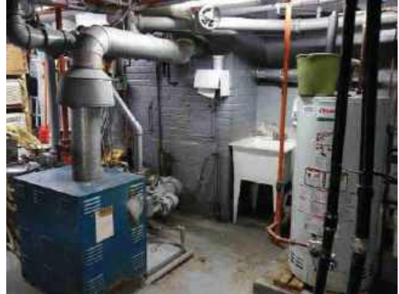
Chaufferie au sous-sol
